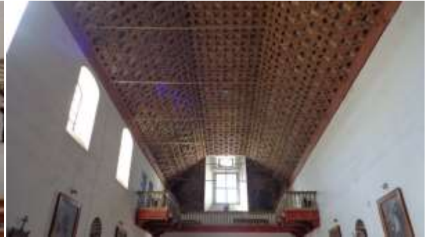
Imagen 10. Vista de cubierta con artesonado de par y nudillo Iglesia de San Miguel
